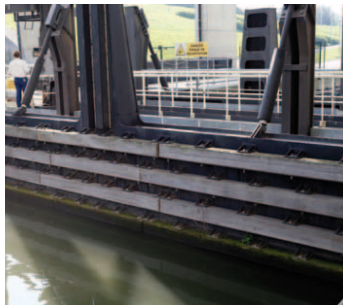
Porte de fermeture d'un des deux bacs à Strépy-Thieu. ©SPW-DPVNI
