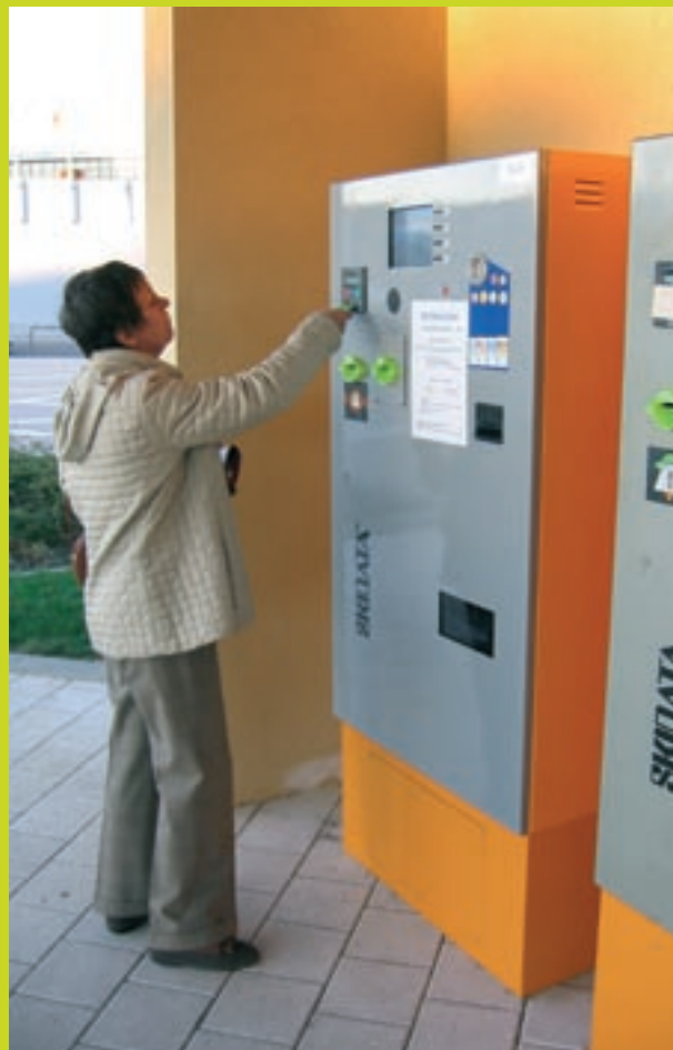
Billetterie/compostage automatique au P+R Namur Expo. Source : ICEDD asbl
