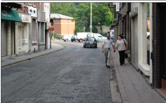
Trottoir concrètement trop étroit ... (Chênée)
