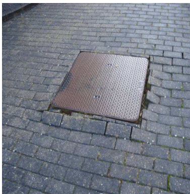
Exemples (Seneffe) où le pavement, le compteur et la borne incendie représentent un obstacle aussi surtout pour les personnes malvoyantes
