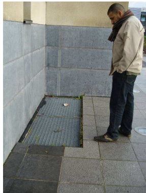
Grille de ventilation présentant une marche importante, non signalée, ni protégée ! Danger!!
