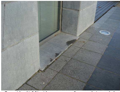
Seuil difficilement franchissable
