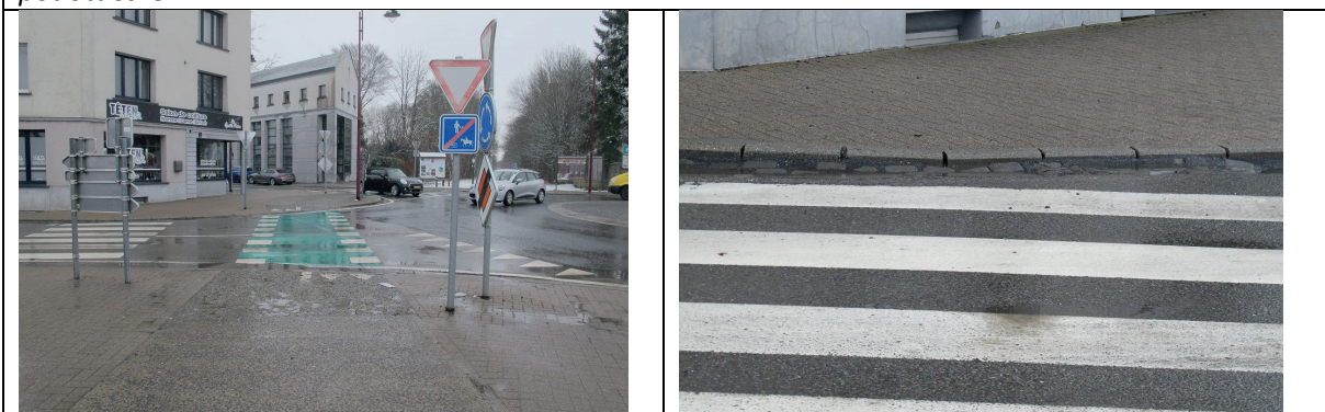
Rond-point Pépinière : aucune traversée adaptée : bordures droites, filet d'eau dégradé, absence de dalles podotactiles
