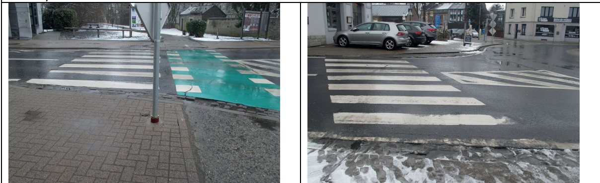
Rond-point Pépinière : aucune traversée adaptée : bordures droites, filet d'eau dégradé, absence de dalles podotactiles
