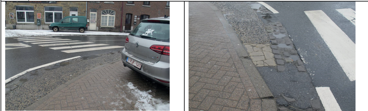
Rond-point Pépinière : aucune traversée adaptée : bordures droites, filet d'eau dégradé, absence de dalles podotactiles
