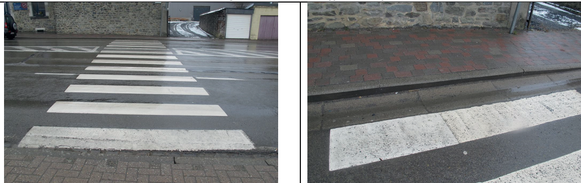
N874 Rue Gustave Delperdange : traversée trop longue, bordure droite, filet d'eau en demi-lune, trottoir trop étroit et en dévers
