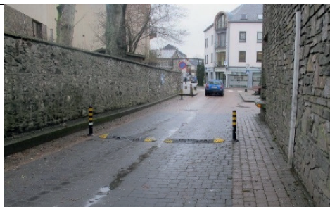
Rue Jean Beck : potelets trop bas. Libre passage insuffisant entre le potelet et le mur + dispositif au sol au centre de la chaussée. Par où sont censées passer les personnes en fauteuil roulant ?
