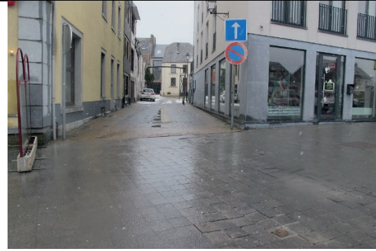
Place Saint-Pierre : dégradation trottoir carrossable entrée rue Saint Pierre
