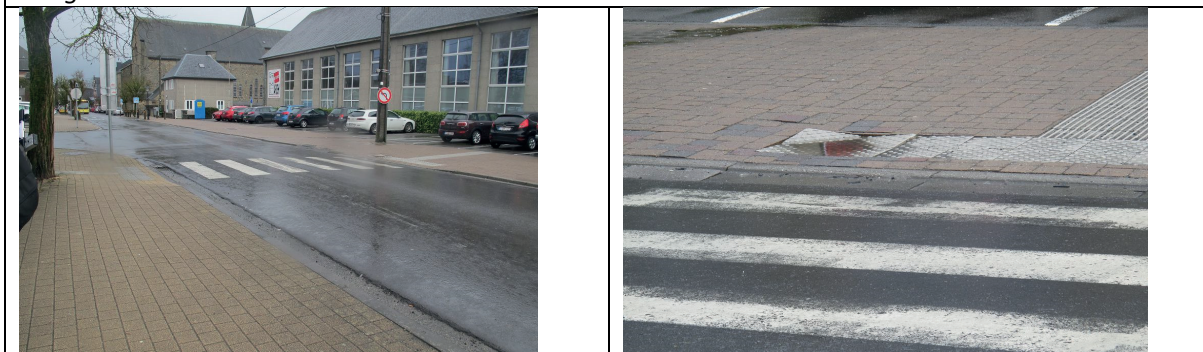
Avenue de la Gare. Attention dégradation dalles podo
