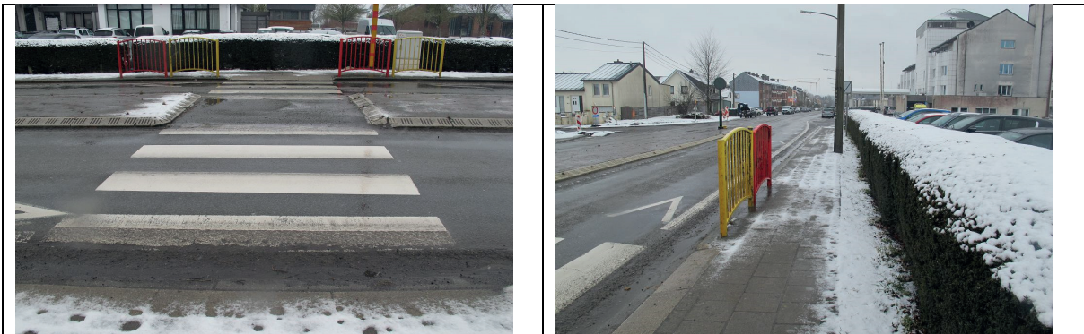
N30 Chaussée de Houffalize : bordure bateau trop pentue, filet d'eau en demi-lune, absence de dalles podotactile
