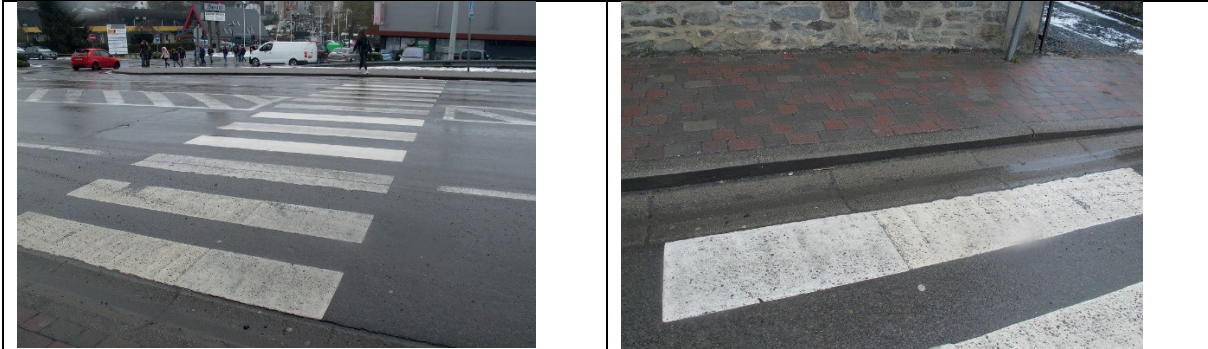
Traversée piétonne infranchissable en fauteuil roulant : bordures droites et filet d'eau. Traversée très longue (3 bandes de circulation+ bande de stationnement) sans îlot de protection.
