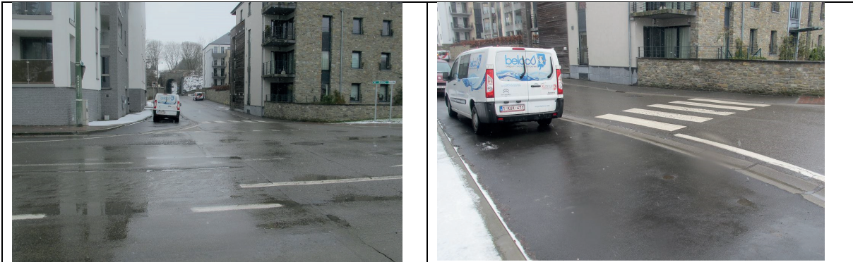
Rue des Déportés : bordure droite, largeur trottoir insuffisante, filet d'eau demi-lune
