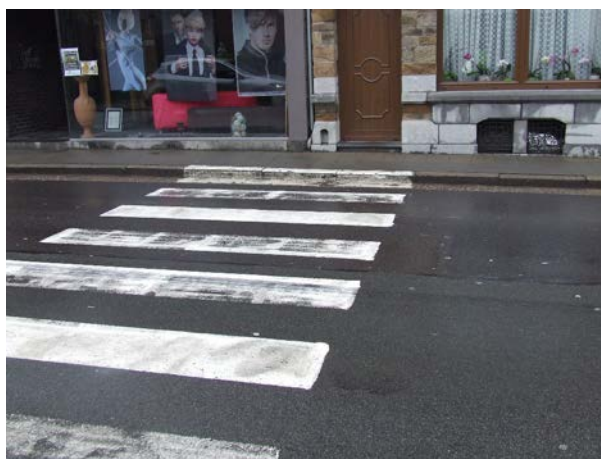
Photo 2. Absence de rampe, de guidage podotactile et de dalles d'éveil au niveau de la traversée piétonne, rue des Combattants (Vaux-sur-Chèvremont)
