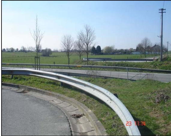
Photo 40 : rupture de la rue de le Croisette
