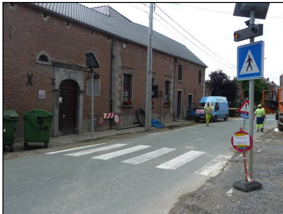
Le passage piéton est signalé par un simple panneau Les abords du lycée sont en travaux Des bennes à ordures à proximité de l'entrée du lycée, gênant les cheminements piétons Absence de dispositifs ralentisseurs visant à faire ralentir les automobilistes
