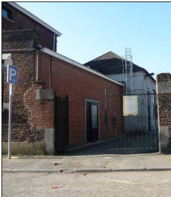
Photo 50: trottoir dégradé dans la rue Jean Jaurès
