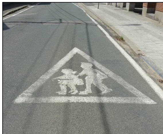
La présence de l'école indiquée par un marquage au sol relativement en mauvais état
