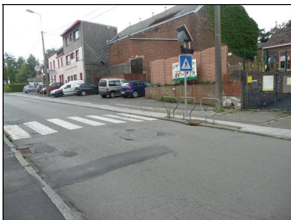
Chaussée en mauvais état Barrières au niveau du passage piéton protégeant la sortie de la cour Absence d'éclairage au niveau du passage piéton Mauvais état du passage piéton (peinture atténuée)
