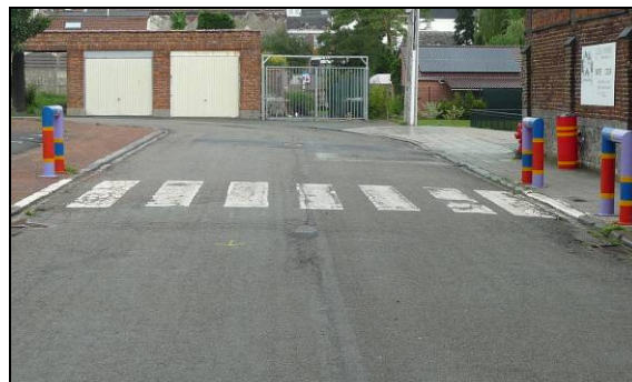
Passage piéton non signalé. Présence de barrières colorées marquant l'emplacement du passage. Marquage au sol du passage piétons en mauvais état
