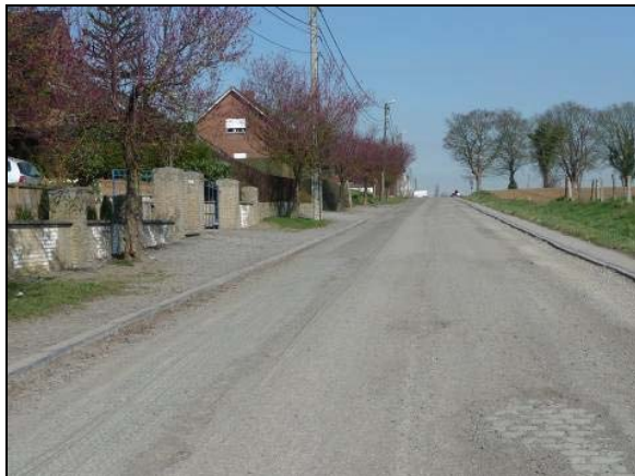
Photo 69 : trottoirs étroits et en mauvais état sur la rue des Carrières de l'Avedelle
