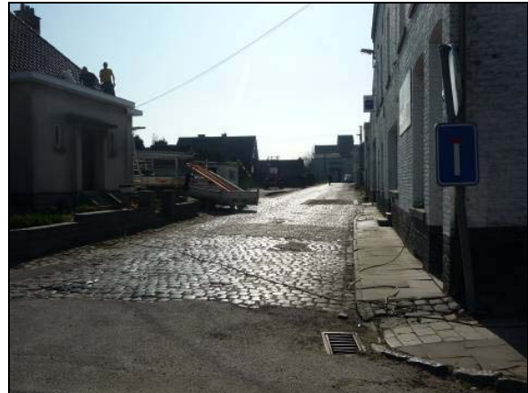
Photo 68 : trottoir en mauvais état au débouché sur la rue de la Justice
