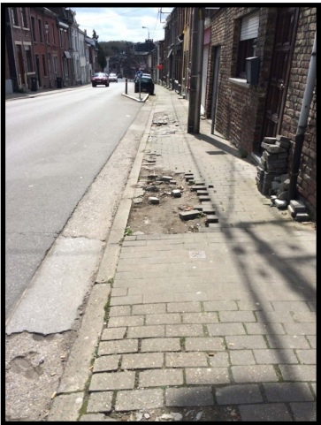
Etat des trottoirs sur la rue Grande
