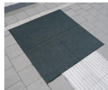
Figure 6. Revêtement en matériaux souples pour indiquer la présence d'une zone d'attente d'arrêt de bus
